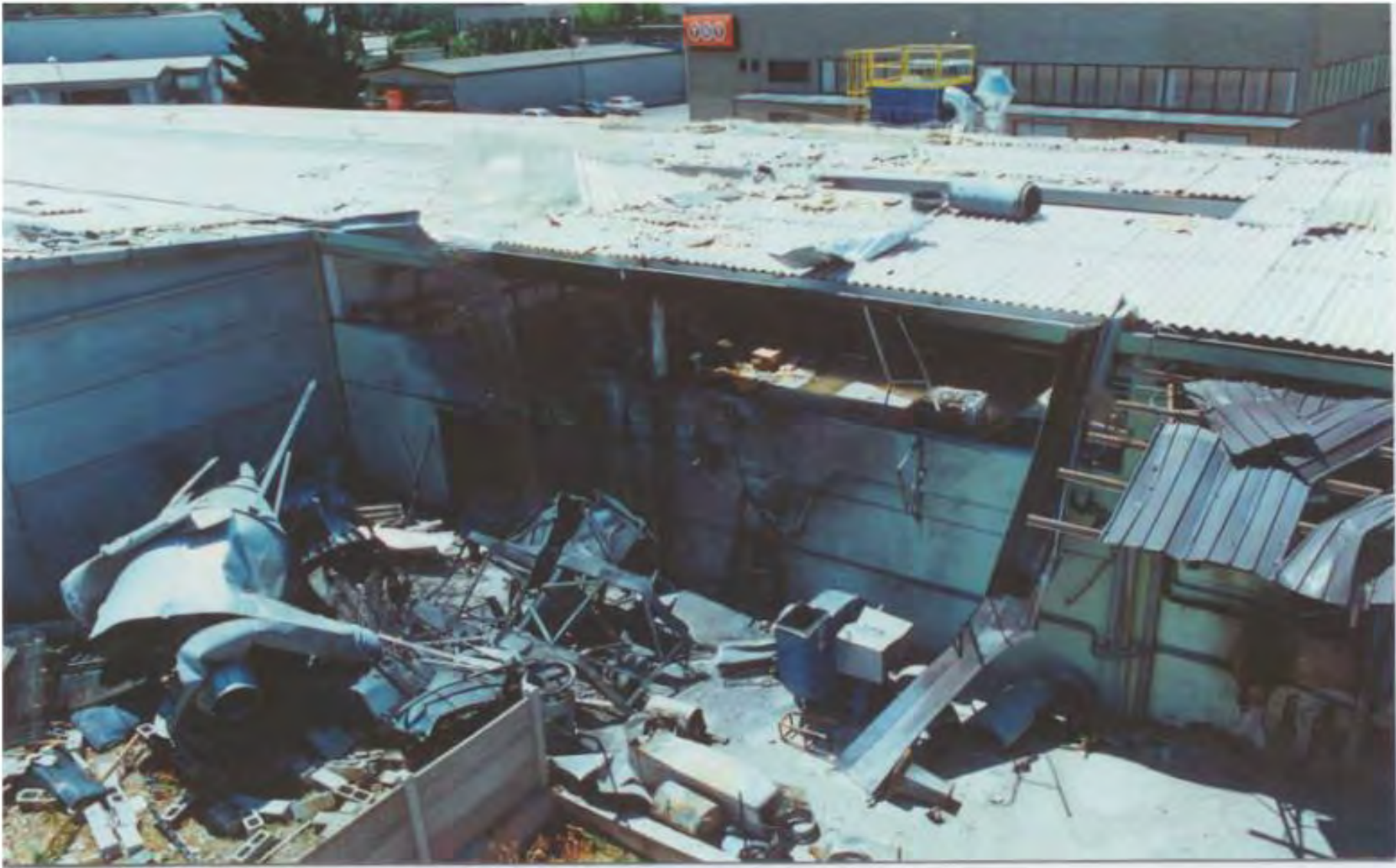
Impianto di aspirazione esploso visto dall'alto
