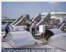
Trattamento acque reflue
